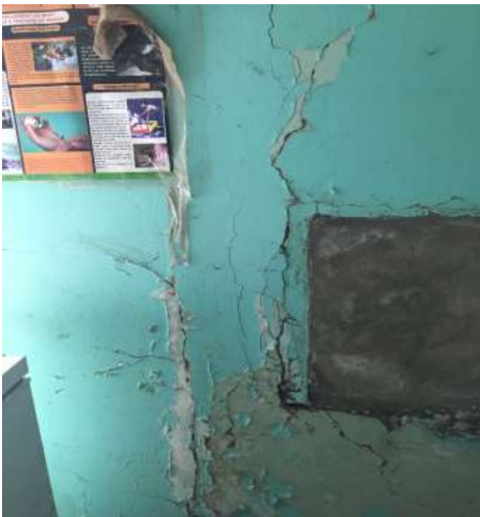
Fissures apparentes aux murs du magasin du PEV ; Rosso, DRAS du Trarza
