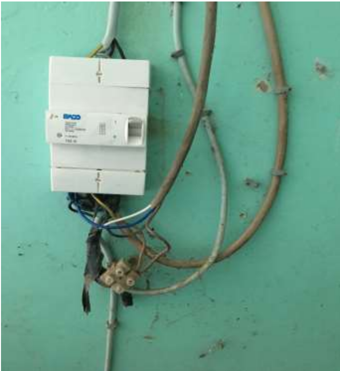
Installation électrique hors norme dans le magasin du PEV ; Rosso, DRAS du Trarza
