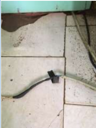
2. Raccord électrique non conforme (et dangereux) de réfrigérateur à vaccin
