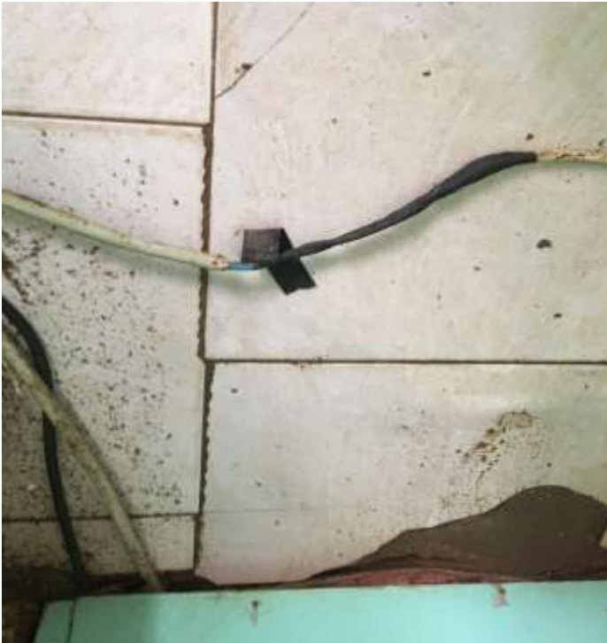
Fils électriques partiellement dénudés courant à même le sol, et servant à l'alimentation des équipements frigorifiques du magasin du PEV ; Rosso, DRAS du Trarza
