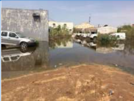
1. Zone inondée autour du bâtiment abritant le stock de vaccins de la DRAS
