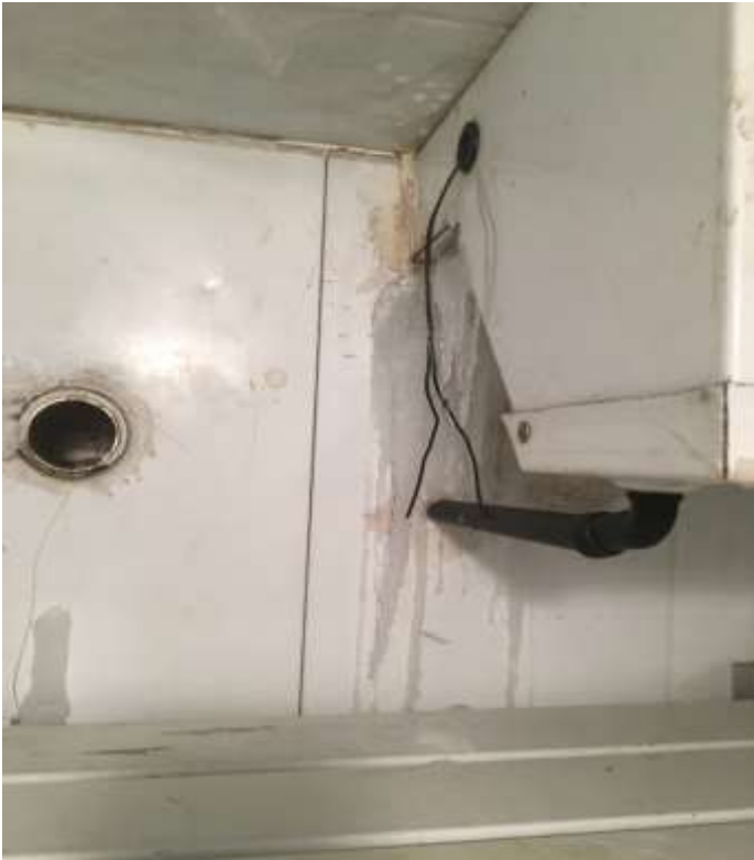
Condensation au niveau du bloc frigorifique de chambre froide ; Nouakchott, Dépôt central du PEV
