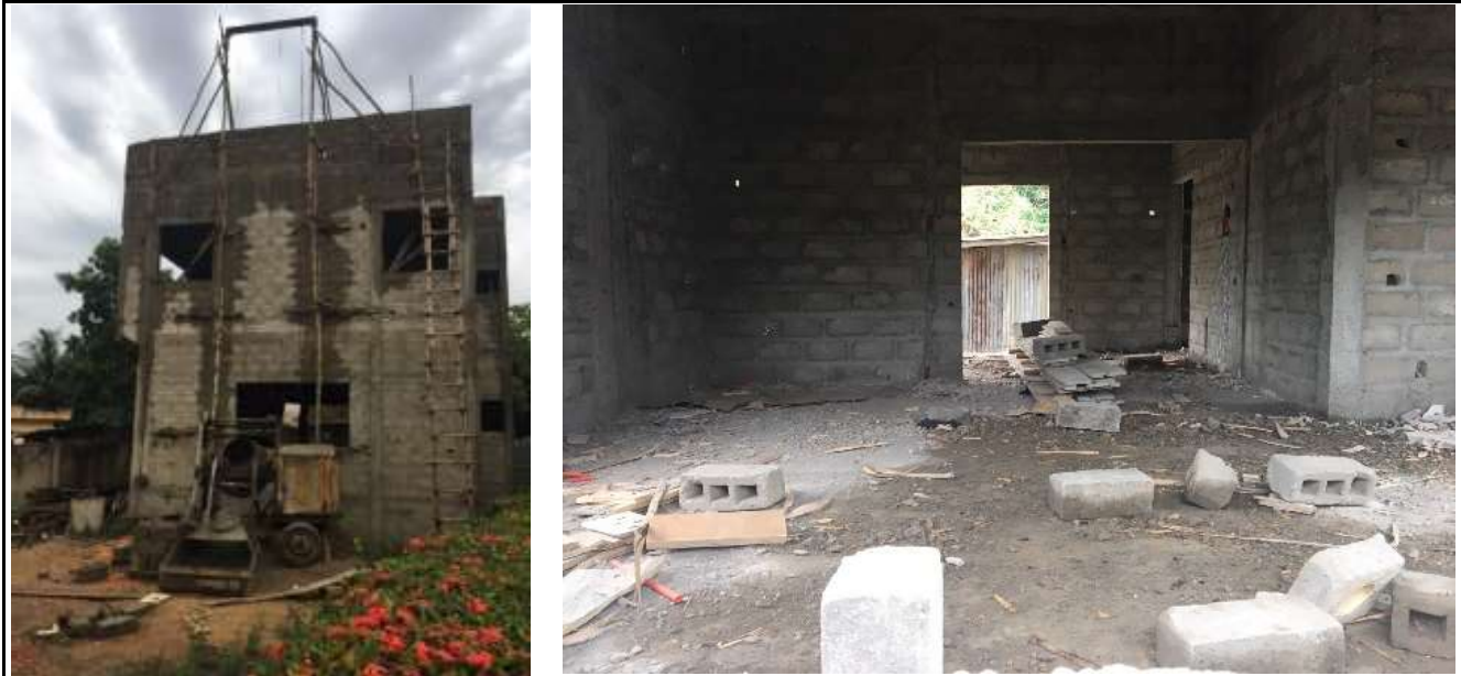
Chantier à l'arrêt (depuis mi-janvier 2018) du nouveau bâtiment de stockage des vaccins pour la DDS Mono (Lokossa), devant accueillir une chambre froide, financé par Gavi.
