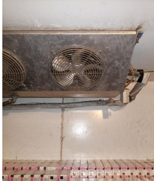
Illustration 2 : ventilation de la chambre froide n°6 non fonctionnelle d’avril à octobre 2022
