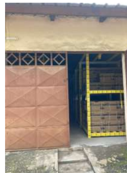
Intrants secs entreposés dans un bâtiment vétuste, non-éclairé et dépourvu d'équipements de lutte contre les incendies
